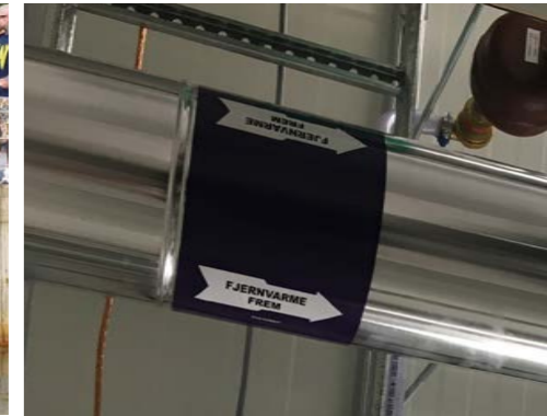
Stencils på rør
